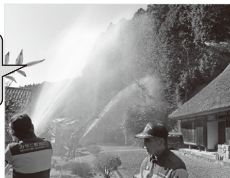
▲備え付けの防火設備を試験操作し有事の対応も確認しました
